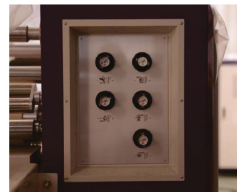
SISTEMA DE CONTROL DE PRESIÓN DE AIRE
